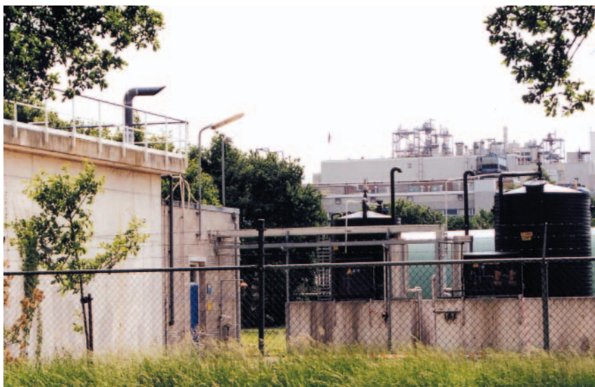
Het biogas van de waterzuivering van Emmtec in Emmen wordt gebruikt voor opwekking van groene stroom, verwarming van een regiokantoor van Essent en opwarming van aardgas.
