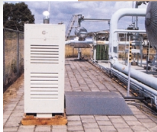
De microturbine van Clyde wachtend op verscheping naar het onbemande platform Q8A
