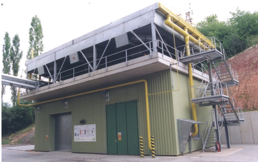
ORC-installatie bij Zementfabrik Heidelberg.
